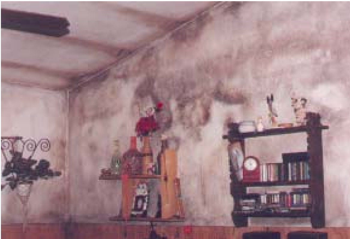
Humedad en forjado superior por puente térmico en las viguetas.
