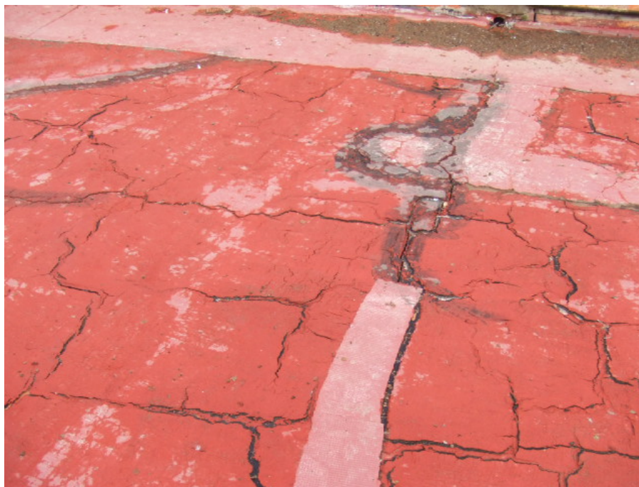
Fisuración de la impermeabilización.
