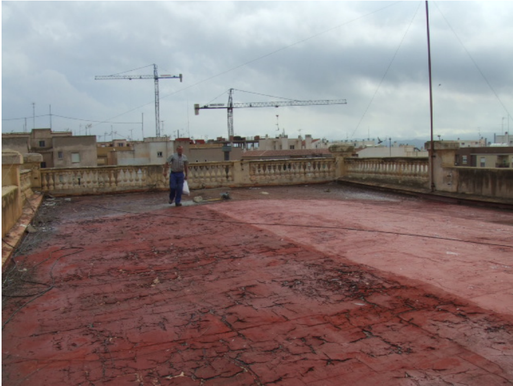
Daños en cubierta reparada con pintura de clorocaucho.
