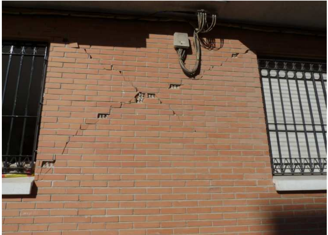
Figura 5.8. Ejemplo de rotura de tabique de cerramiento entre ventanas.
