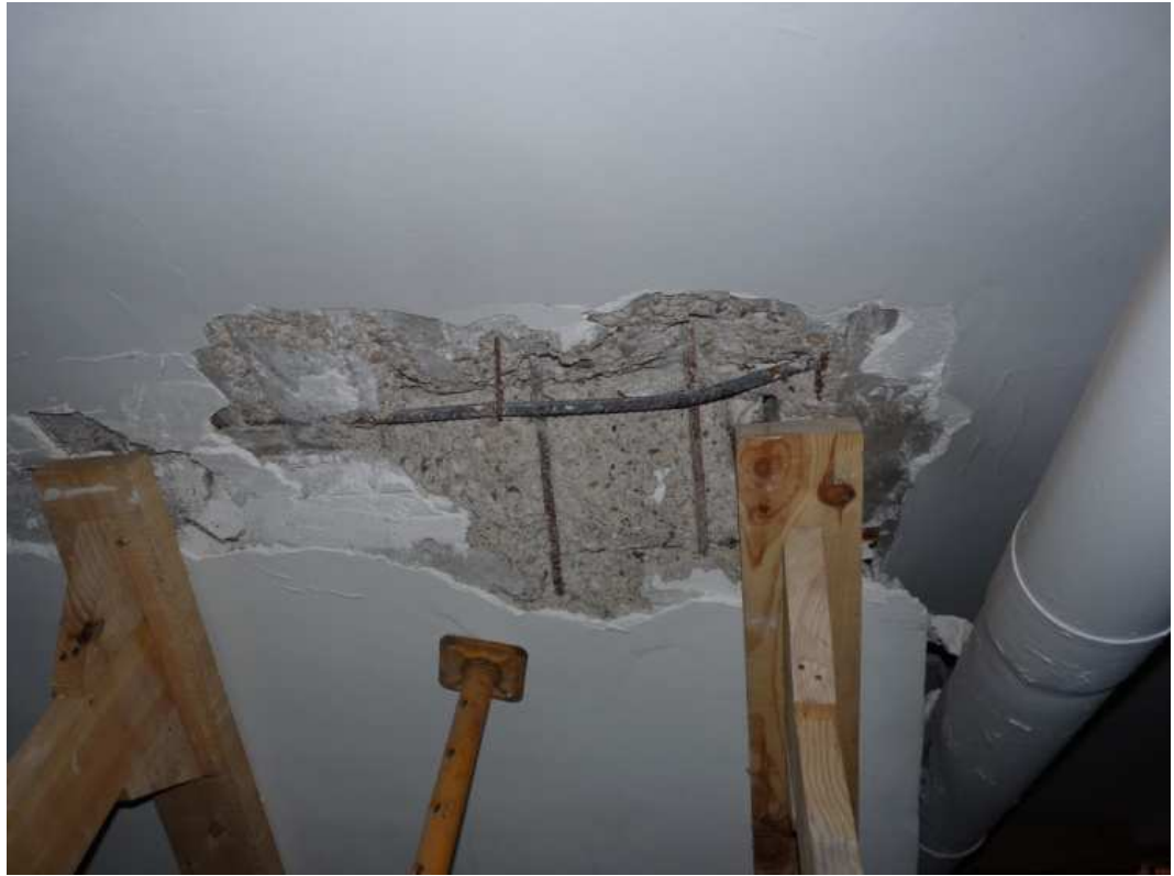
Figura 5.14. Daños en desembarco de escalera.
