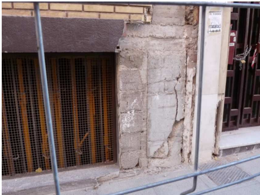
Figura A-1.15. Pilar corto del edificio de la calle Jardineros.
