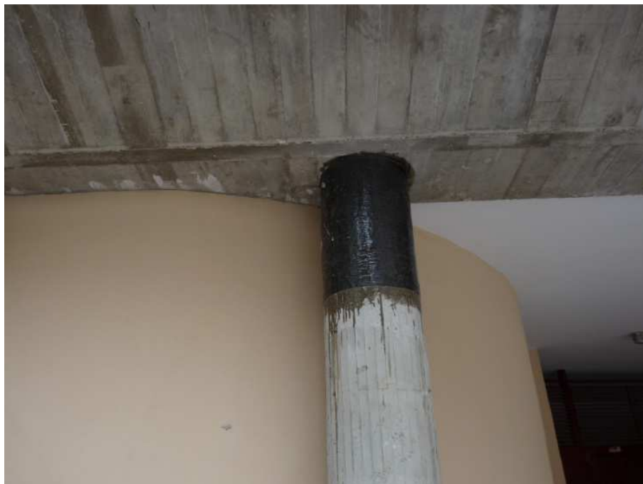
Figura A-2.1. Refuerzo por medio de fibras de carbono en cabeza de pilar
