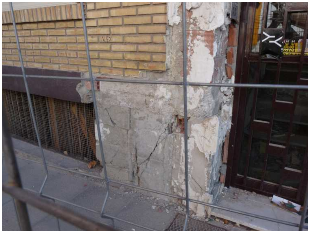
Figuras 5.5 y 5.6. Roturas de pilares cortos entre muro de sótano y planta baja.
