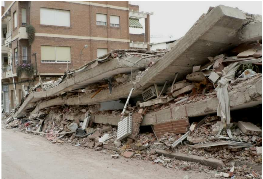
Figura 5.4. Ejemplo de edificio colapsado con planta baja diáfana.
