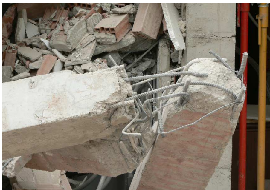
Figura 5.13. Rotura de pilar con longitudes insuficientes de anclaje.
