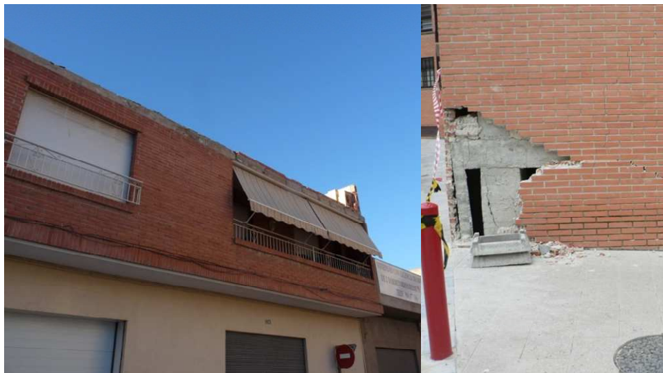
Figura 5.12. A la izquierda, vista de un edificio tras la demolición de la cornisa afectada por el sismo. A la derecha, caída del revestimiento en fachada de ladrillo visto en planta baja.
