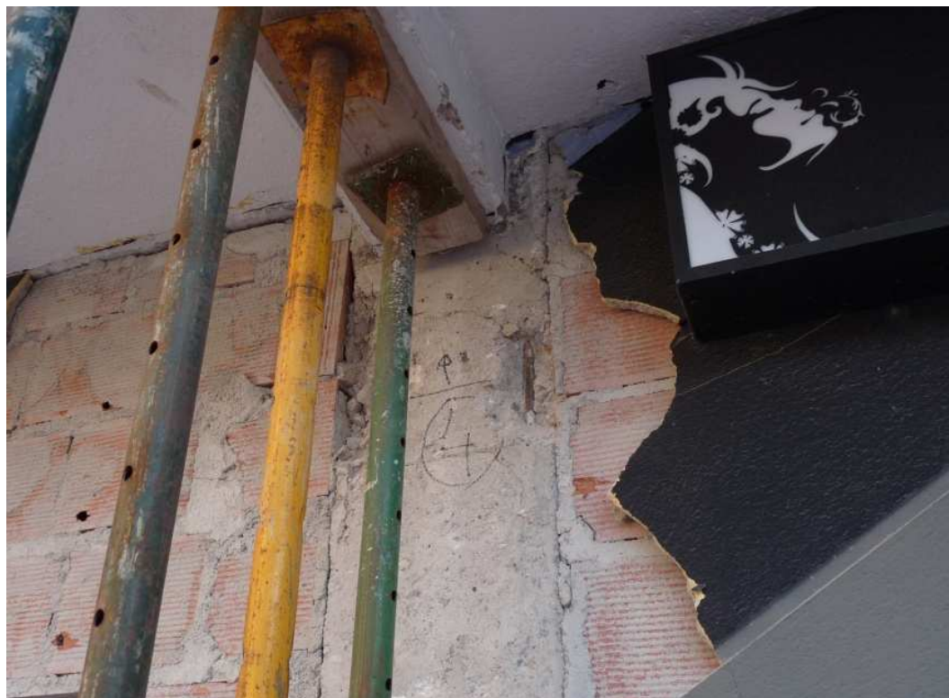
Figura 5.2. Pérdida de recubrimiento en pilar y fisuras de trazado oblicuo.
