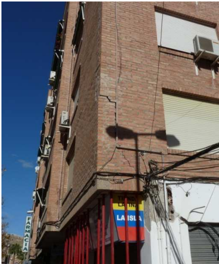
Figura 5.11. Daños en fachada debidos a movimientos de voladizos.
