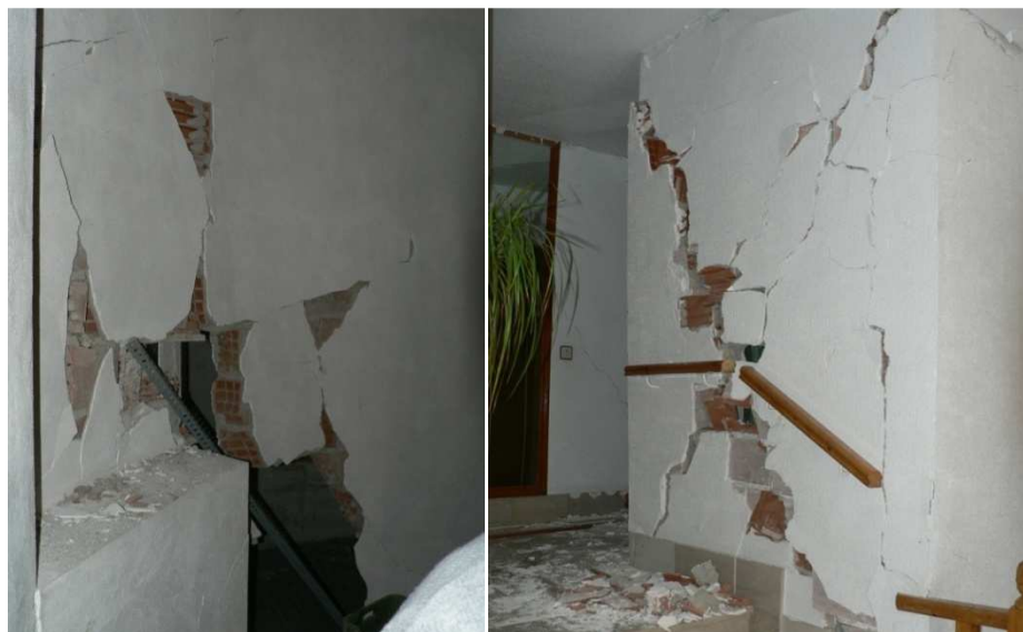
Figura 5.9. Rotura de tabiques por acción horizontal de cortante debida al sismo
