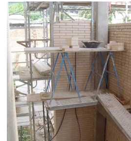
Imagen 3. Mal montaje. (Google imagen)
