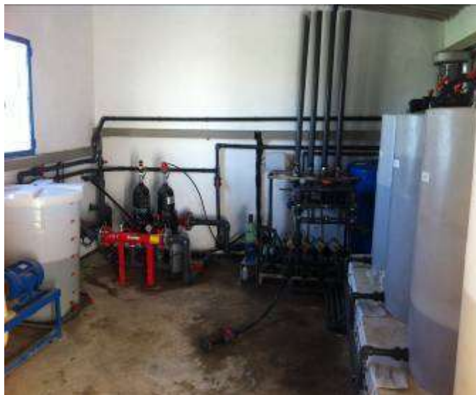
Fig. 2. Detalle del cabezal de riego
