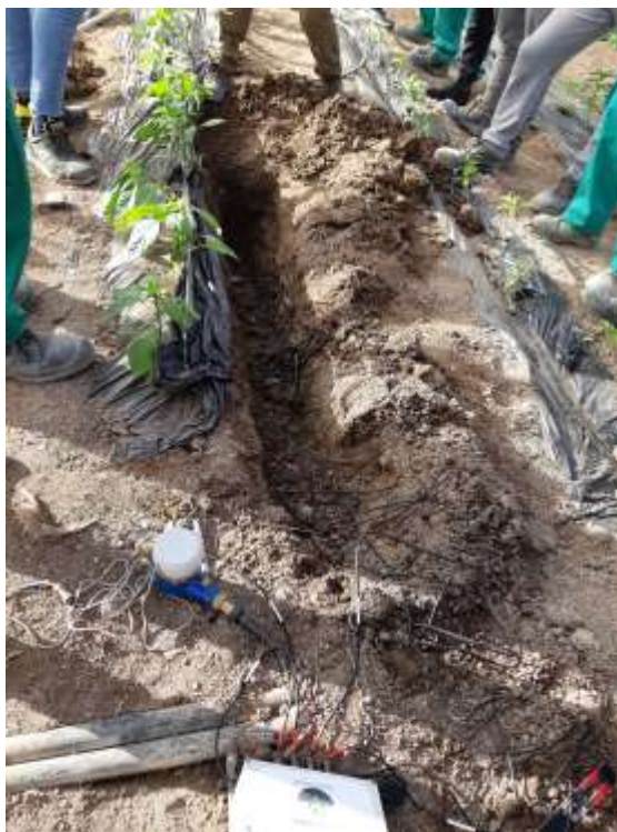
Foto nº 16. Colocación de sensores, caudalímetro y datalogger en invernadero (08/11/2019).
