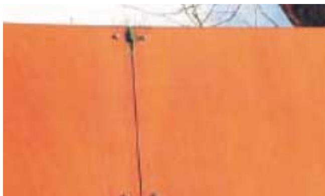
La acumulación de residuos en la junta puede dar luz a la aparición de vegetación
