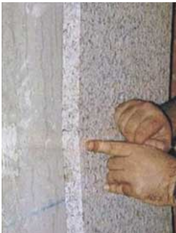
Aspecto después de la rotura
