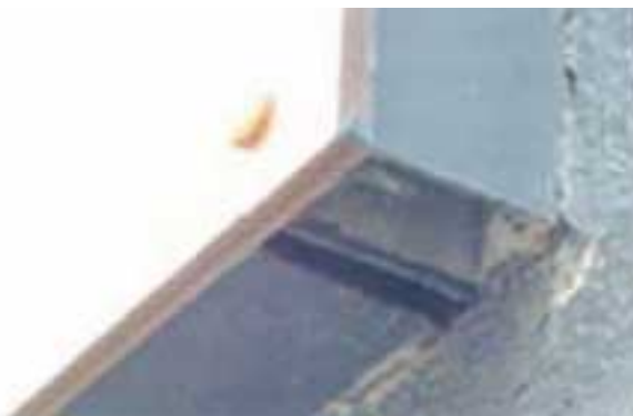
Cámara con perfil impidiendo la ventilación
