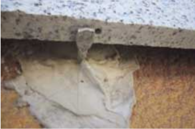
Traslado desplazado (fuera del eje de la pieza) y además doble taladro excesivamente próximos
