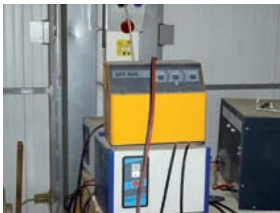
Detalle de cargador de baterías.
