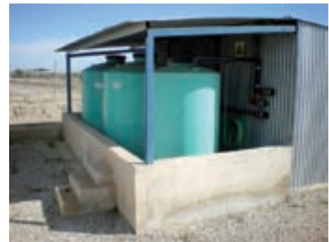
Tanques fertilizantes en el interior del cubeto de retención.
