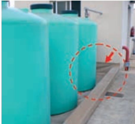
Lámina plástica de polietileno recubriendo el cubeto para protegerlo de la posible corrosión provocada por derrames o fugas de fertilizantes de reacción ácida.
