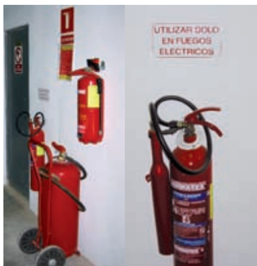
Equipo de extinción de incendios, extintor de CO 2 para fuegos eléctricos.
