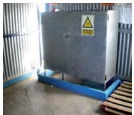
Armario metálico para el almacenamiento de fitosanitarios, con cubeto y suelo de hormigón.
