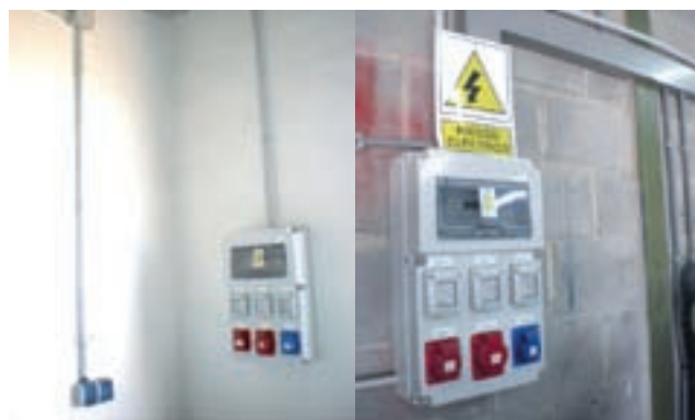
Instalaciones eléctricas en casetas agrícolas conforme al reglamento REBT.
