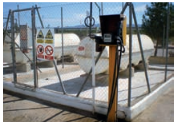
Depósito para el almacenamiento de gasóleo B en una explotación agrícola.
