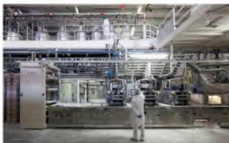
Planta de dosificación de productos de goma.
