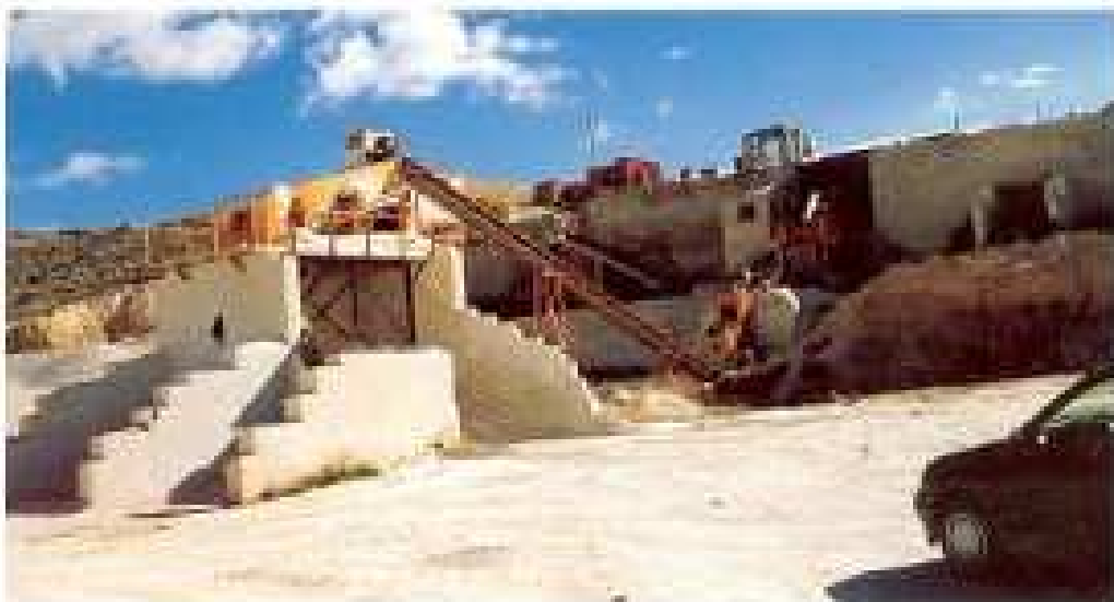
• Vista de la planta de tratamiento.
