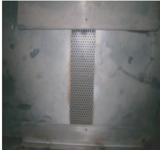
Figura IV.17 Tabiques deflectores y malla de acero inoxidable de 6 orificios de 2 mm de diámetro por cm 2 situadas antes de los filtros para uniformizar la mezcla aire-humo.
