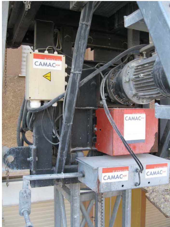
Imagen 15. Dispositivo contra empalamiento (freno centrífugo) protegido por la carcasa roja.
