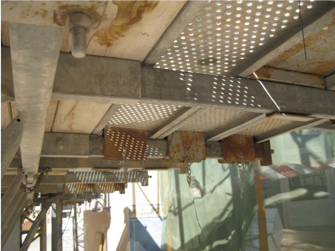
Imagen 11. Vista inferior de la plataforma con las extensiones.
