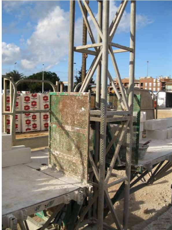
Imagen 6. Protector de mástil con altura insuficiente por faltarle el módulo superior.
