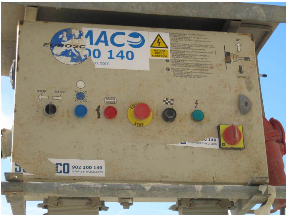
Imagen 12. Cuadro de mando con interruptor general, mando sensitivo (lateral derecho), sirena (lateral izquierdo) y parada de emergencia.
