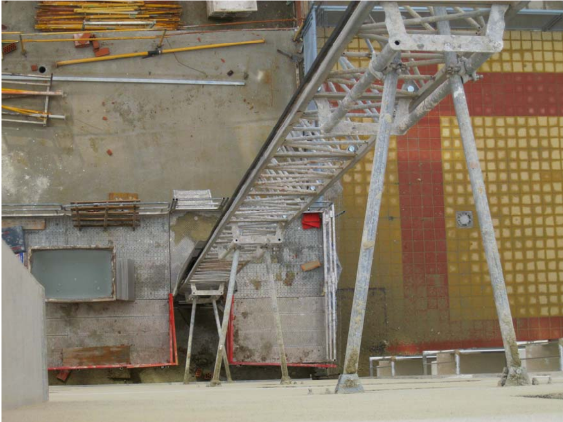
Imagen 7. Anclajes de mástil a fachada.
