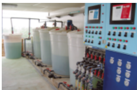
Automatismos de fertirrigación.
