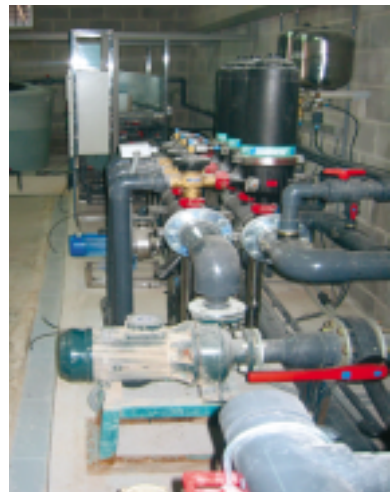
Batería de filtros y bombas.
