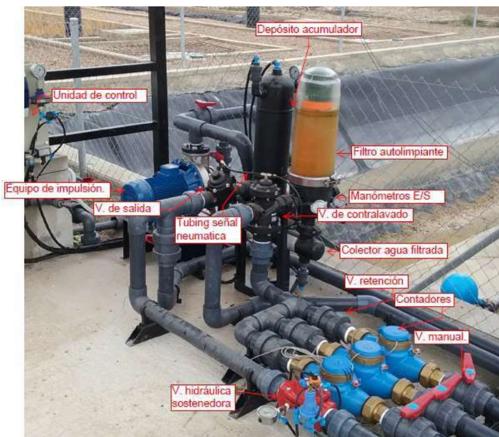
Fig. 2 Detalle equipo de filtrado.
