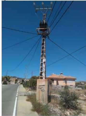
Detalle del CT a reformar, con acebuche en su entorno inmediato.
