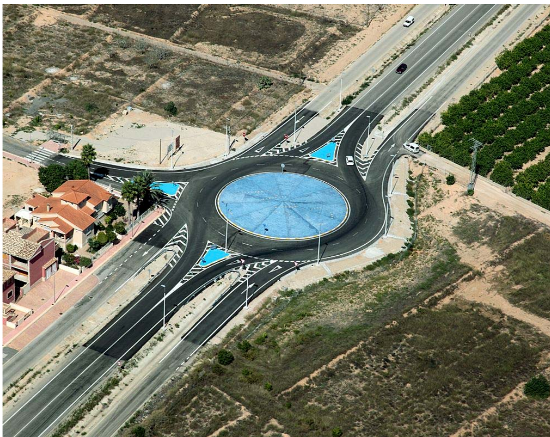
CONSTRUCCIÓN DE GLORIETAS EN RM -414 ACCESOS A LA GINETA Y EL RELOJ.
