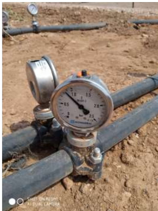
Imagen nº6 Manómetro en la zona de riego cinta
