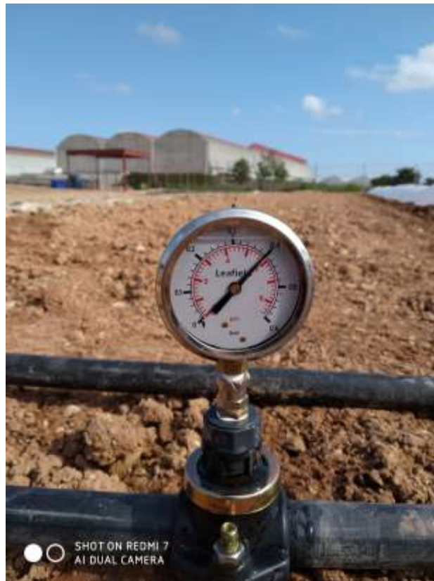
Imagen nº5 Manómetro en la zona de riego Visareg
