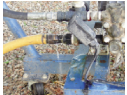
Pérdida por una conducción.
