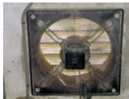
Sistema de ventilación.
