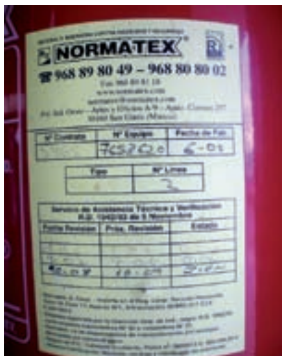
Etiqueta mantenimiento extintor.
