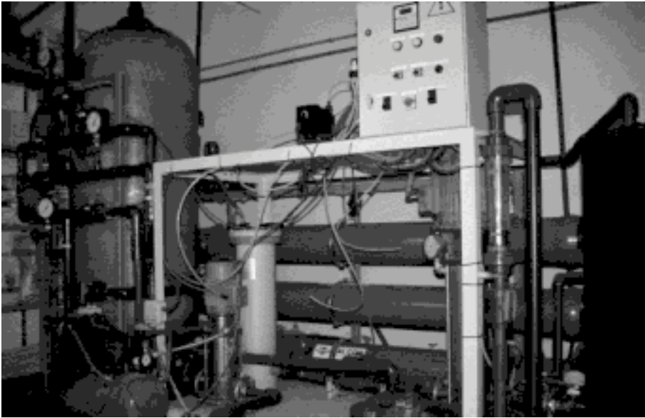
Planta desaladora de ósmosis inversa de un semillero profesional.
