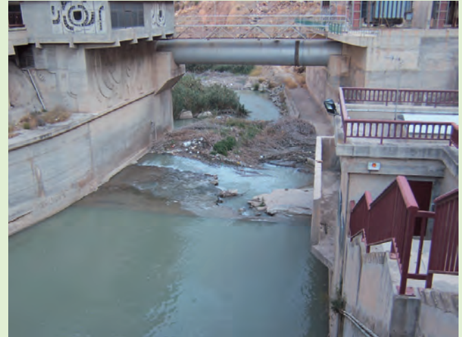
El azud de Ojós, una de las instalaciones más importantes del sistema de regadíos de la Región
