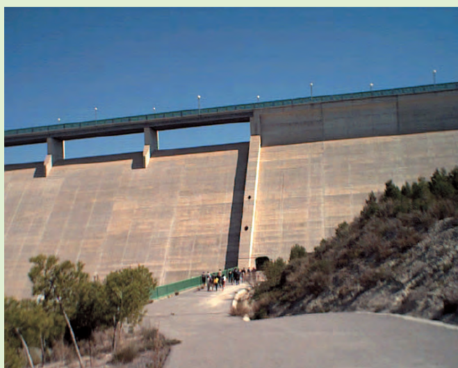
Presa de la Rambla del Judío, construida para frenar posibles inundaciones producidas por tormentas
