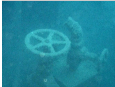
Foto 53. Toma de agua del sistema contraincendios.
