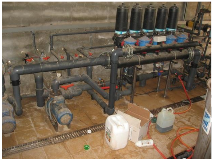
Bombas inyectoras y filtro
