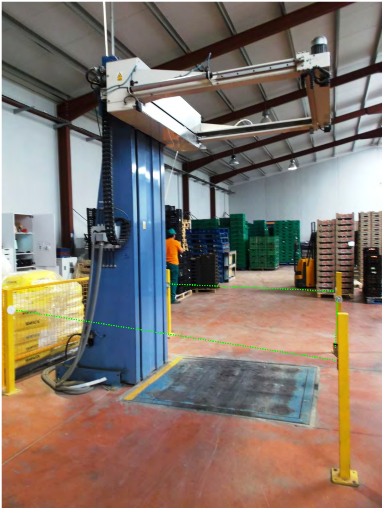
Figura 11. Ejemplo dispositivos fotosensibles utilizados en una flejadora para impedir el acceso a la zona de movimiento del mecanismo de elevación/bajada del canal de flejado durante funcionamiento
