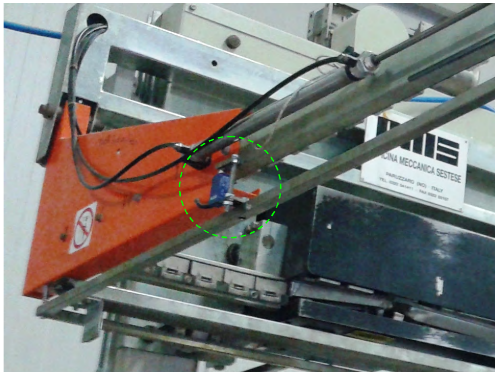
Figura 13. Detalle dispositivo de protección contra fuerza ejercida en Flejadora
