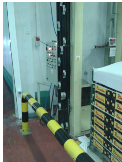
Figura 5. Órganos de accionamiento situados junto a zona de paso de carretillas elevadoras
