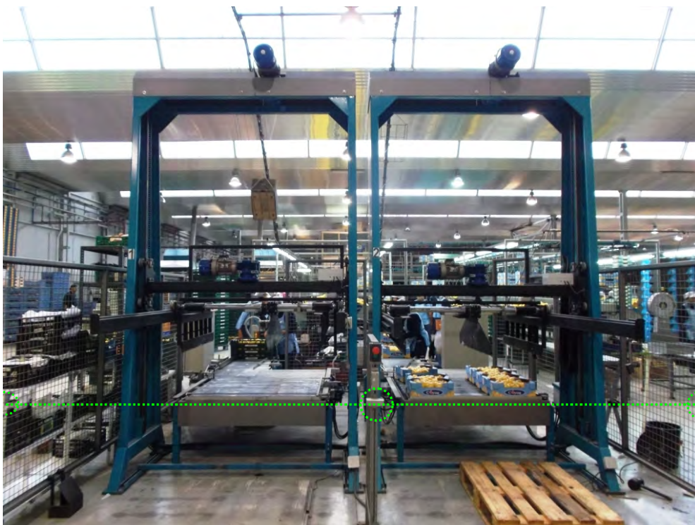
Figura 8. Ejemplo donde un único dispositivo fotosensible, instalado a 0,8 m. de altura con respecto al suelo no impide acceso a zona de operación de dos Paletizadores
