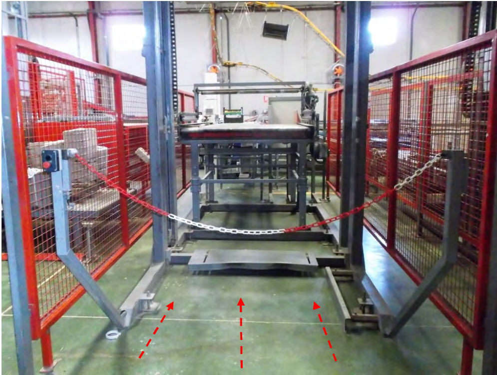
Figura 7. Ejemplo de sistema de protección (cadena) que no impide acceso a zona de operación de un Paletizador
