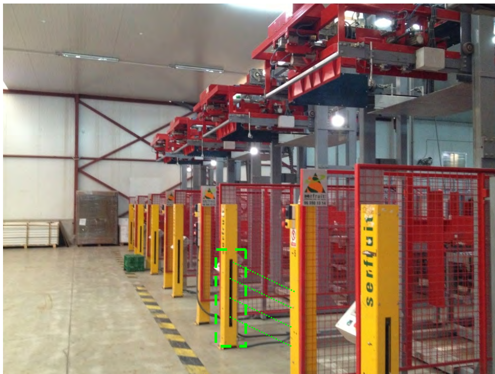
Figura 10. Dispositivos fotosensibles utilizados para impedir el acceso a la zona de peligro (ejemplo barreras inmateliales instaladas en seis paletizadores)
