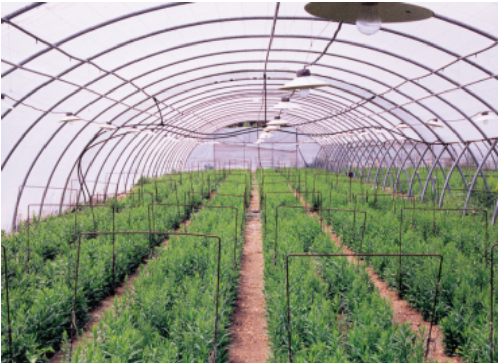
Instalación de iluminación fotoperiódica.
