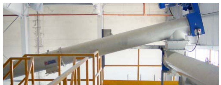
Fot. 2: Protección de tubo
