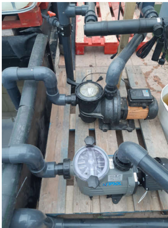
Bombas de caudal para movimiento del agua
