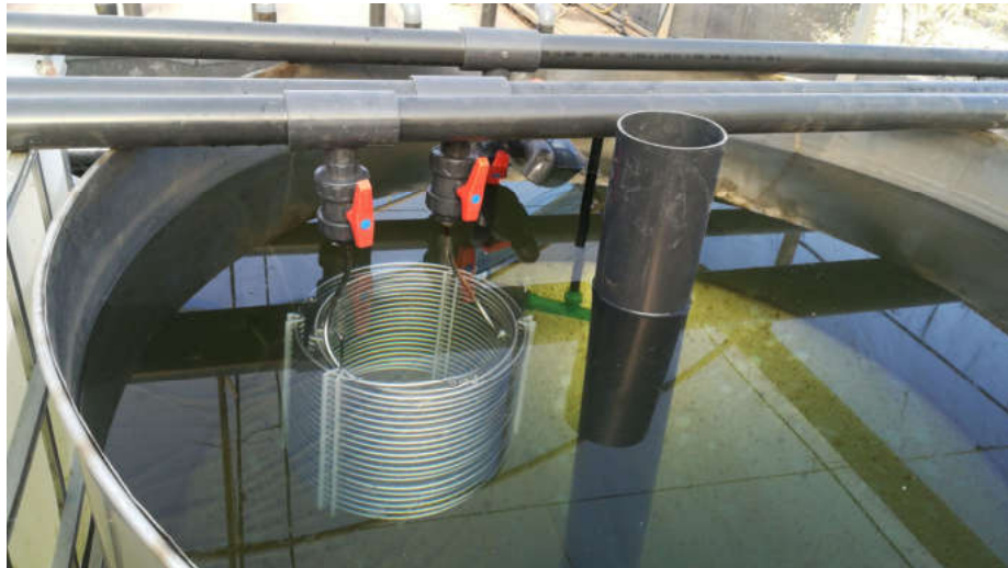
Intercambiadores de calor de anillos circulares en depósito cónico de acero
