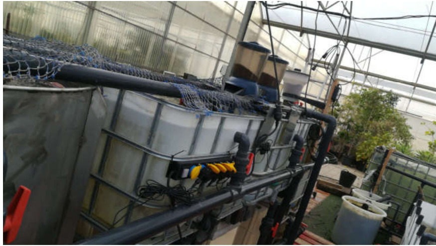
Nuevos depósitos instalados 28/12/2020
