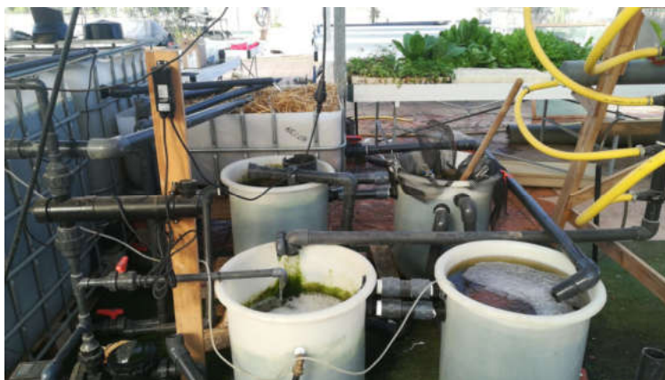
Depósitos de aireación planta nº 2 (29/10/2020)
