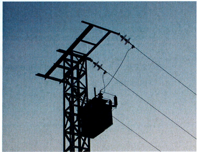
Apoyo con las autoválvulas instaladas sobre el propio CTI (Correcto).
