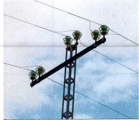
Apoyo con dos aisladores rígidos por fase
