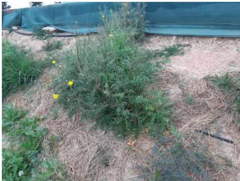
Foto nº 19. Invasión de malas hierbas en zonas no protegidas del talud (18/02/2020).
