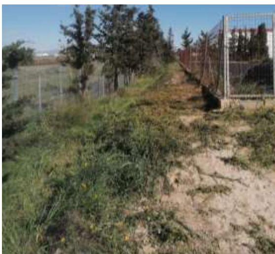
Foto nº 18. Invasión de malas hierbas en zonas no protegidas del talud (02/03/2020).
