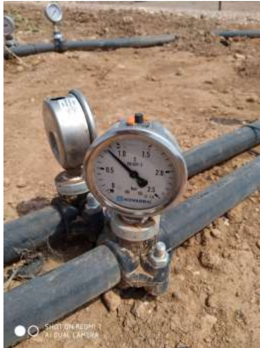
Imagen nº6 Manómetro en la zona de riego cinta
