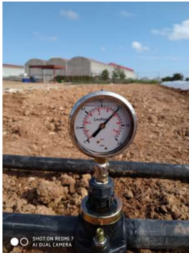
Imagen nº5 Manómetro en la zona de riego Visareg
