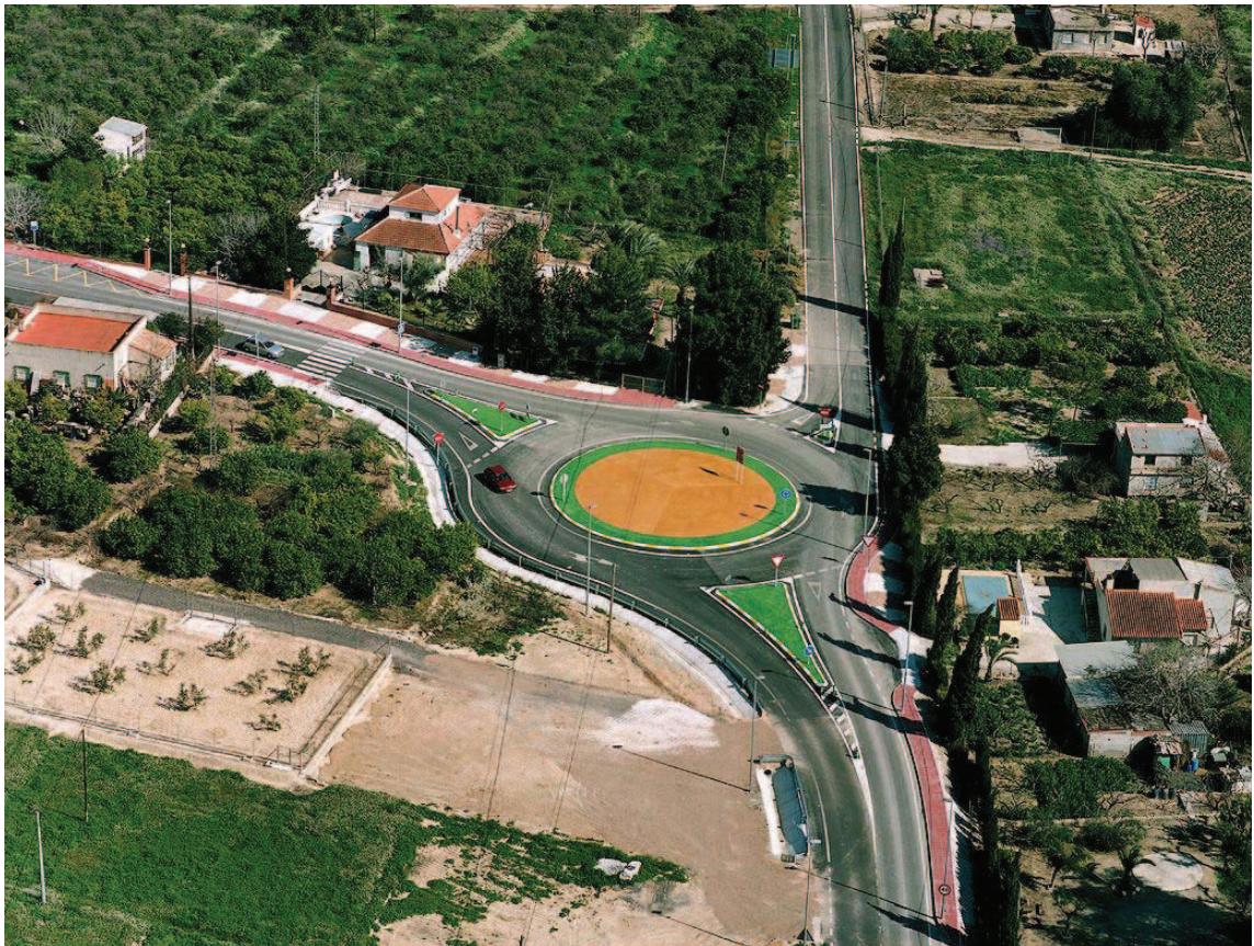
CONSTRUCCIÓN DE GLORIETA EN RM-B6 CON CAMINO DE TORRE MONTIJO MOLINA DE SEGURA
