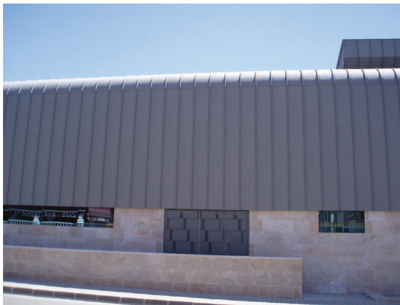
Figura 3.4.a Revestimiento de cubierta y parte de la fachada de un edificio con planchas de cinc en la actualidad
