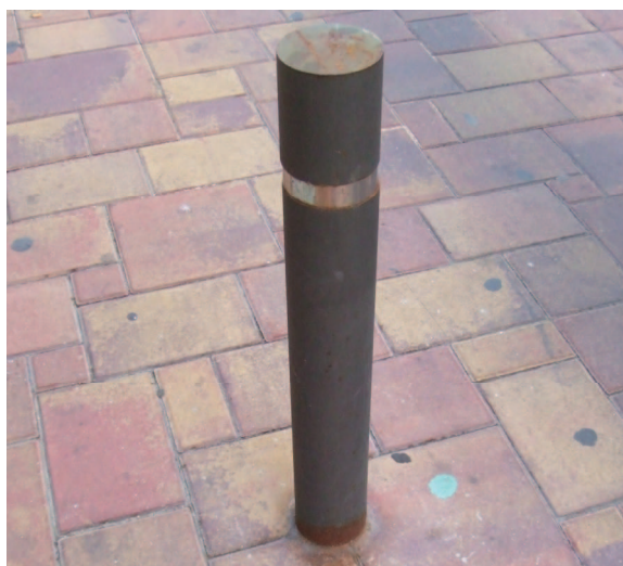
Figura 10.2. El diseño plano de la cara superior de este bolardo permite la permanencia del agua de lluvia y el polvo favoreciendo el inicio de la corrosión. Otra zona sensible es la próxima al suelo.
