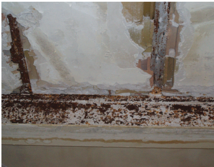
Fotografía 6.3 Filtraciones constantes de agua y corrosión intensa de los elementos metálicos de una estructura
