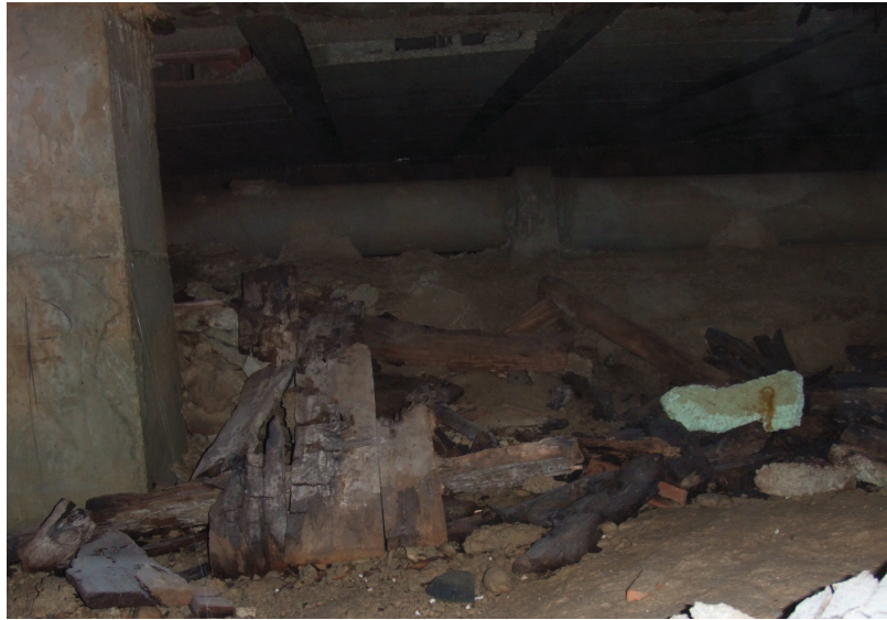
Figura n° 5.1.b Aspecto de una cámara sanitaria totalmente humedecida. La madera abandonada está en estado de pudrición.
