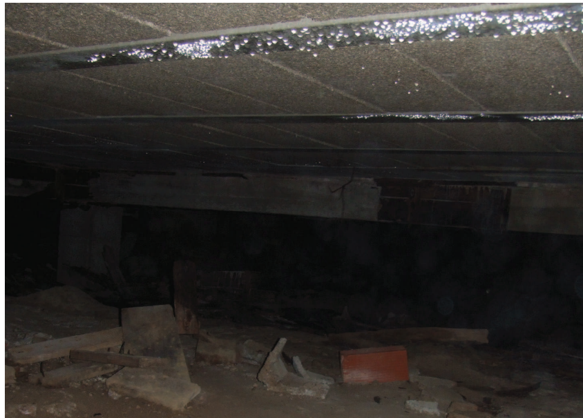
Figura 4.3. Aspecto del agua condensada sobre la cara inferior de las viguetas.
