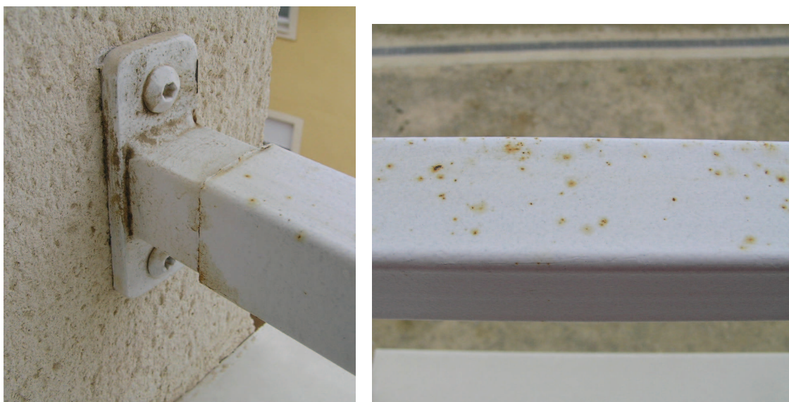
Ejemplo de referencia: Barandilla de acero con inicio de corrosión
