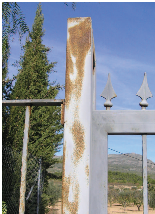
Figura 10.6.a Elemento metálico deficientemente recubierto con procesos de corrosión iniciados.
