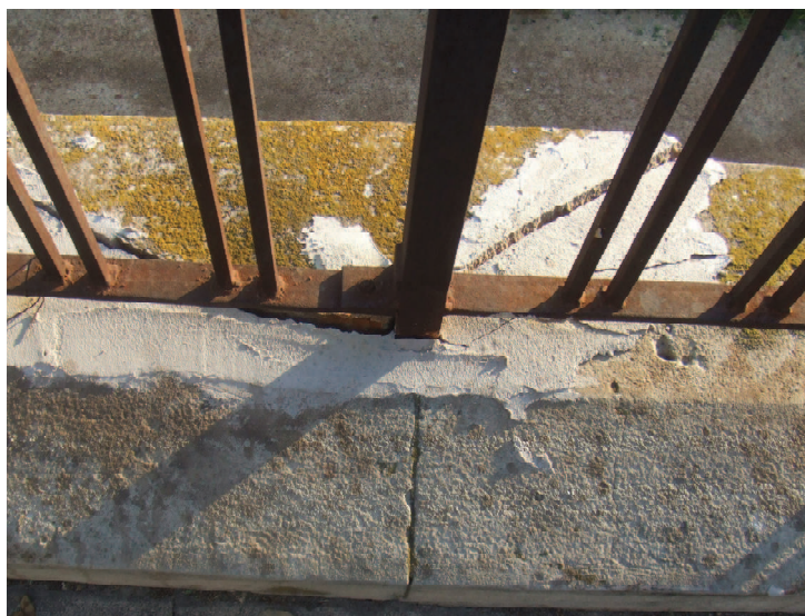
Figura 7.3.a Rotura de unas piezas de piedra por la expansión de óxidos metálicos. La pseudo reparación ha resultado inútil.
