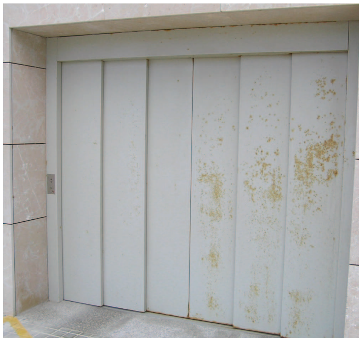
Figura 7.3.b. Puerta de un ascensor para automóviles corroída en la parte más accesible a los vientos marinos. Se aprecia el tono rojizo de los óxidos de hierro emerger a través de las capas de pintura.
