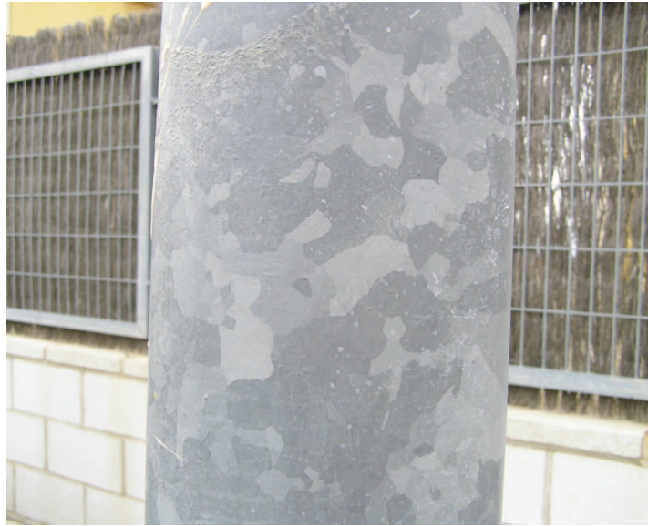
10.5.1 Fuste de una farola galvanizado con el clásico efecto del “floreado”. Obsérvese ciertas acumulaciones de cinc, en la parte superior propias de un proceso de inmersión en caliente.
