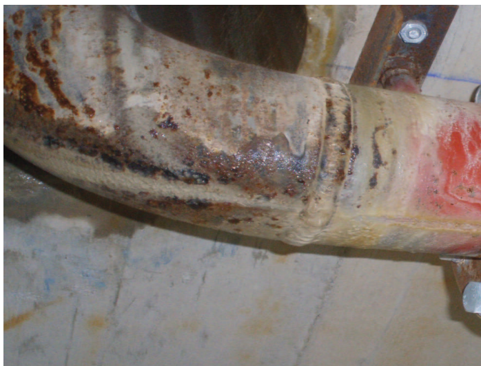
Ejemplo de referencia: Codo de acero negro con síntomas de corrosión
