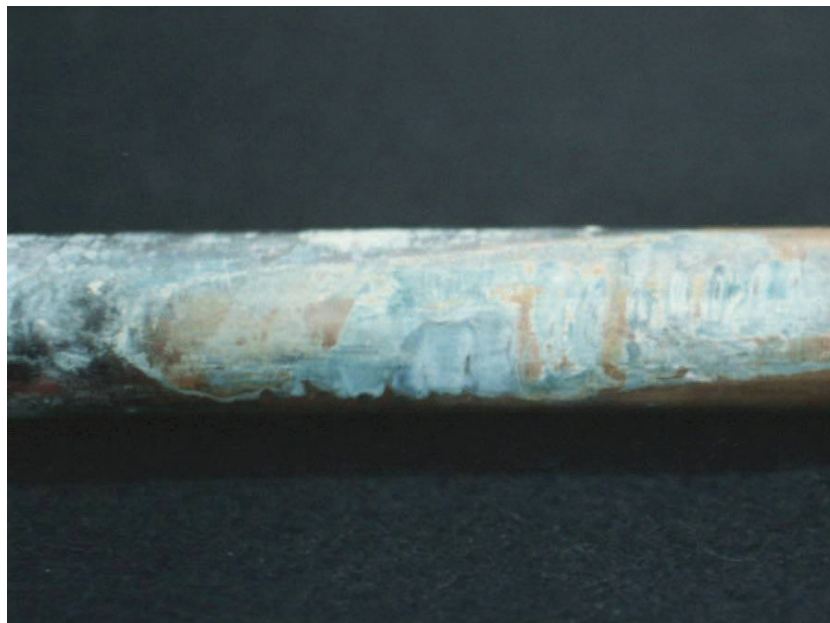
Figura 8.3 Superficie exterior de un tubo de cobre con corrosión
