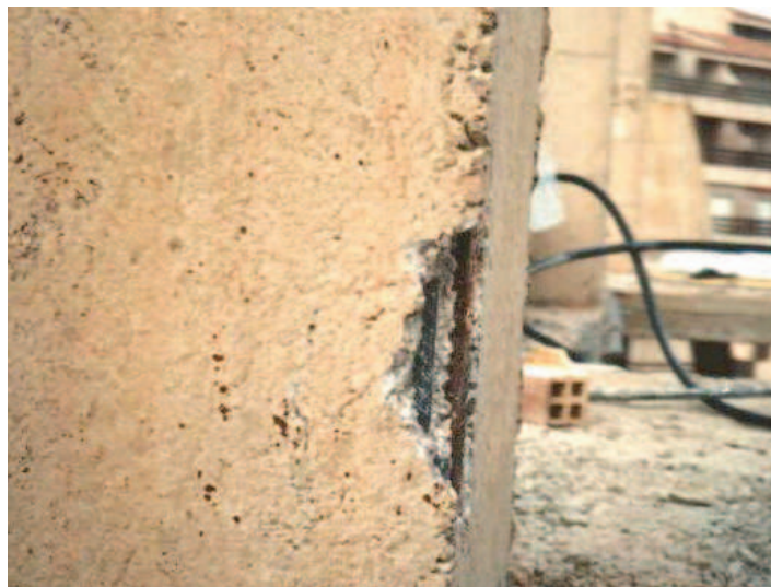
Figura 9.4.1.1 Dos barras del mismo elemento con distinto espesor de recubrimiento una de ellas corroída
