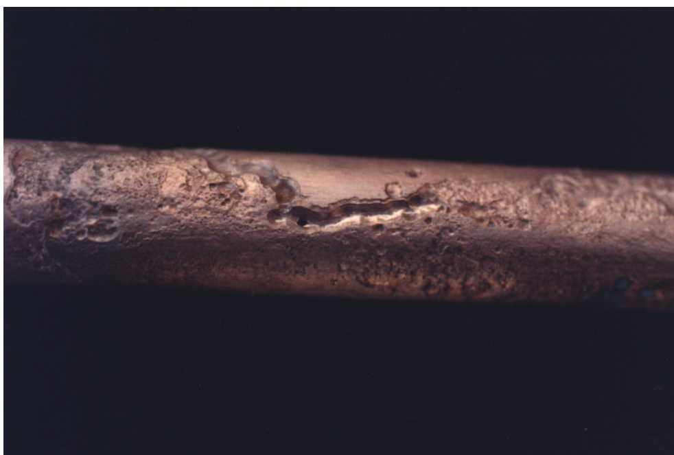
Ejemplo de referencia: Corrosión de un tubo de cobre
