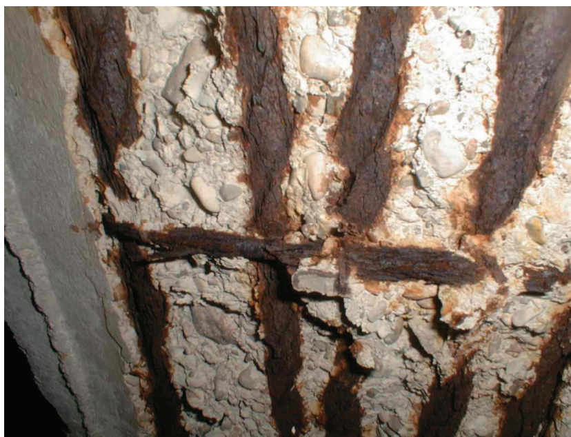
Corrosión de las armaduras de una viga tonel desprendimiento del hormigón de recubrimiento.
