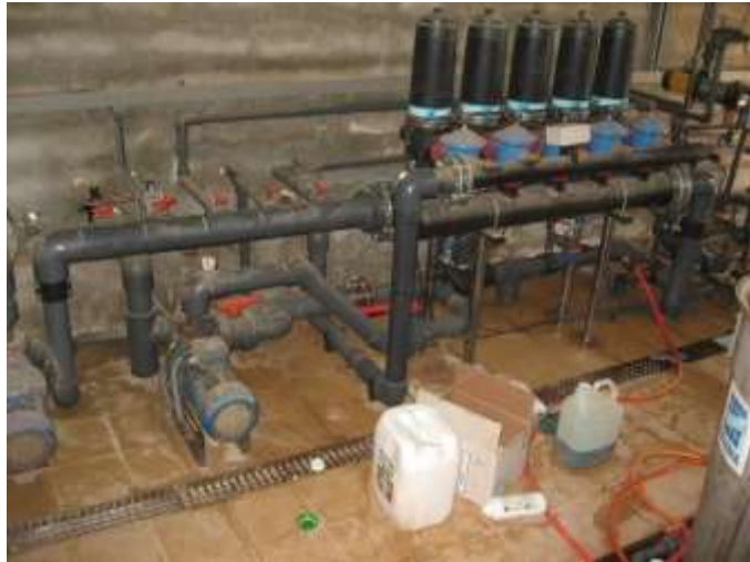
Foto 7: Bombas inyectoras y filtro
