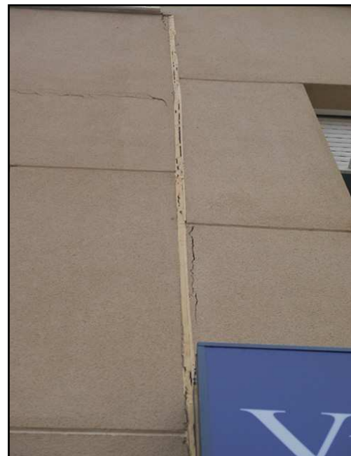
Figura 11. Juntas de dilatación mal respetada en el revestimiento exterior. Fachada de ladrillo revestido de monocapa en edificio plurifamiliar. Avenida de Europa (Murcia)
