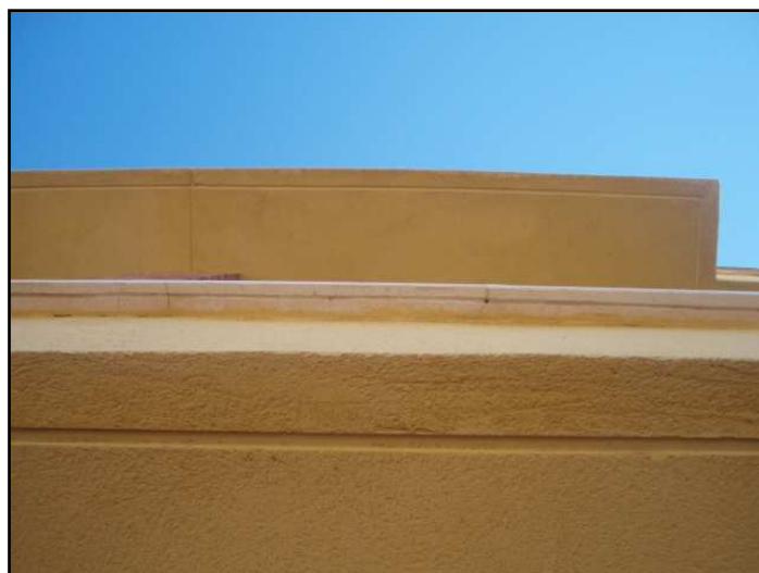
Figura 20. Goterones en bordes de forjado. Vivienda unifamiliar en Llano de Brujas. Murcia
