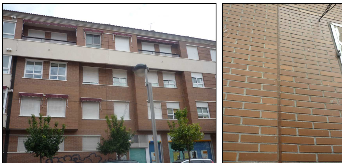
Figura 14. Junta de dilatación respetada en el cerramiento. Fachada de ladrillo visto en edificio plurifamiliar. La Flota. Murcia
