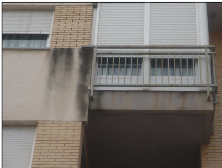
Figura 10. Manchas de suciedad por lavado diferencial. Edificio plurifamiliar en La Flota Murcia.
