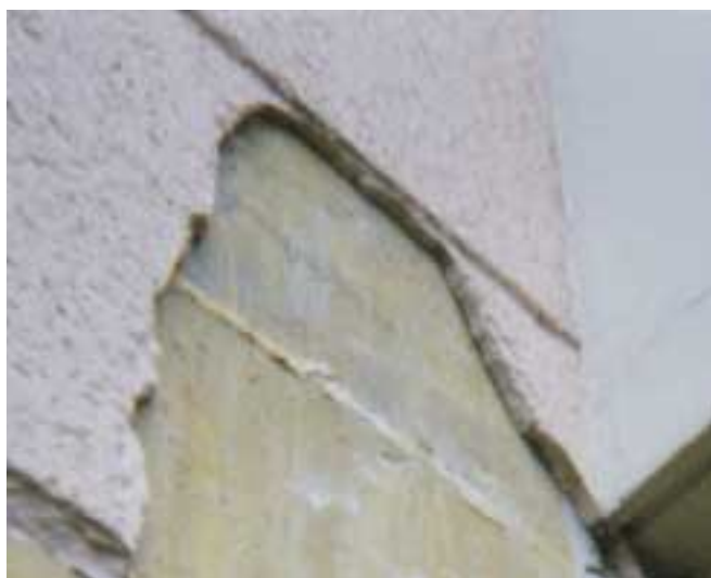
DESPRENDIMIENTOS: El revestimiento endurecido presenta fisuras superiores a 1 mm.
