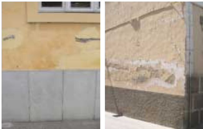
EFLORESCENCIAS EN ZÓCALOS: Depósitos de sales sobre la superficie del revestimiento en las partes bajas de los edificios.
