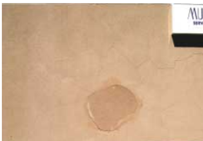
FISURACIÓN EN TELA DE ARAÑA: Las fisuras son visibles a distancia (superiores a 2 mm) en forma de red o de tela de araña. El revestimiento puede "sonar a hueco", indicando su falta de adherencia al soporte. Pueden coincidir con desprendimientos localizados del revestimiento.
