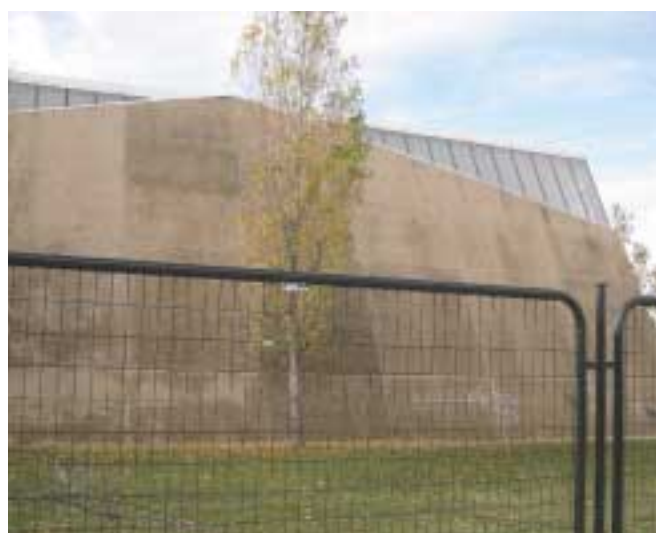
MANCHAS DE ESCORRENTIA: La contaminación ambiental se fija en la superficie del revestimiento, efecto que se ve favorecido por una humedad ambiente alta y la lluvia.
