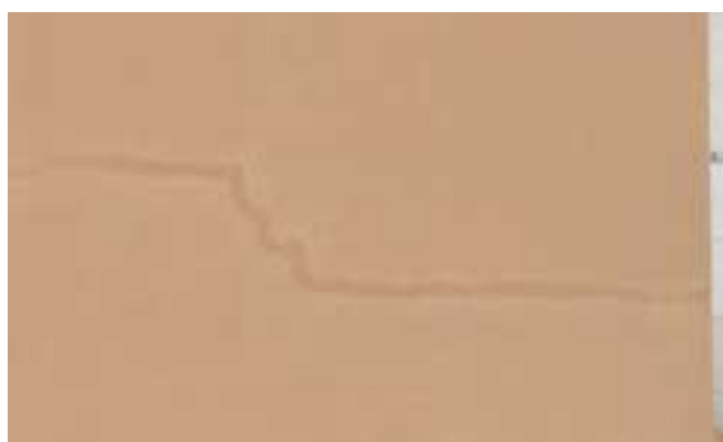
GRIETAS: La grieta, aparentemente superficial, proviene de un fallo estructural.
