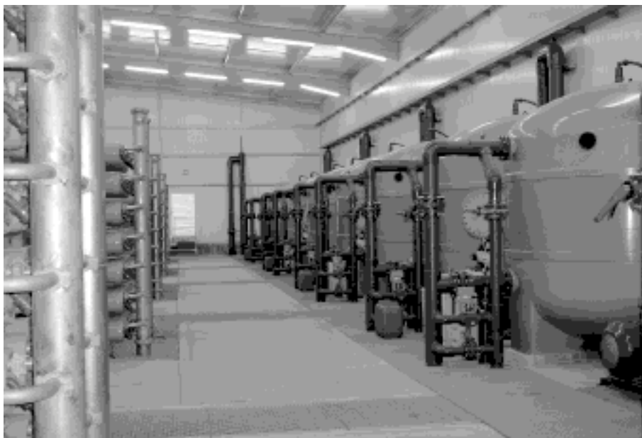
Foto 4.15. Equipo para filtrado y desalación de aguas destinadas a regadío.
