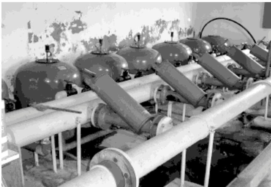
Foto 4.14. Equipo para filtrado y desalación de aguas destinadas a regadío.
