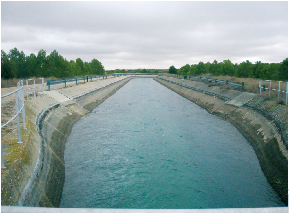
El trasvase Tajo-Segura a su paso por Palomares del Campo (Cuenca). Foto: J.A. Prieto Prieto.
