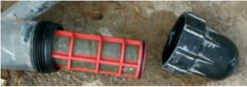
Fotografía 3.6: Filtro de malla. Se empiezan a apreciar precipitados por carbonatos.
