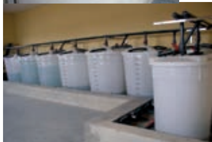
Fotografía 1.7: Tanques de fertilización y cubeta de recogida de pérdidas.
