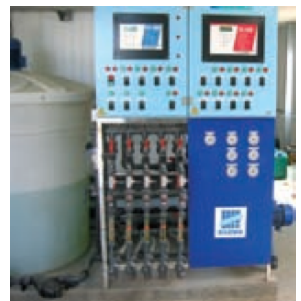
Fotografía 3.7: Equipo automático de fertirrigación.
