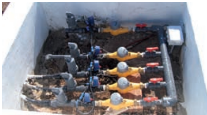
Fotografía 1.11: Arqueta de control para 5 unidades de riego. Consta de ventosa, electroválvula, contador y llave de bola para cada sector.
