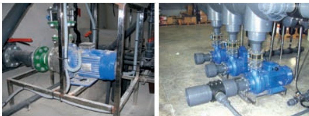
Fotografía 1.2: Bombas de presión en paralelo en una instalación de riego.
