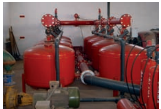
Fotografía 1.4: Batería de filtros de arena.
