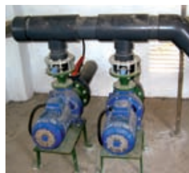
Fotografía 3.2: Equipo de bombeo.
