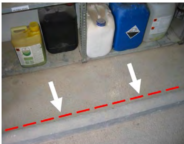
Rebordo a modo de cubeto en estanterías para fitosanitarios
