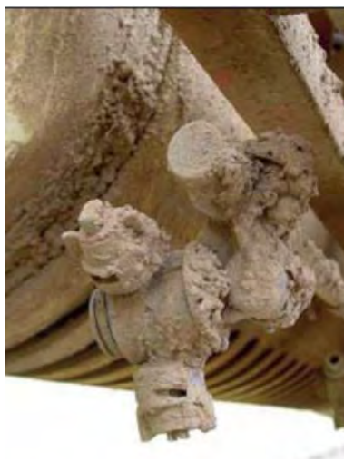
Boquillas obstruidas por suciedad
