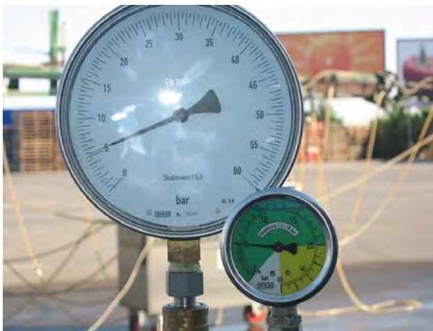
Comprobación del manómetro, subiendo la presión y después bajando.
