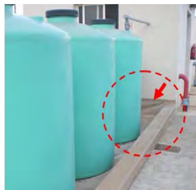
Lámina plástica de polietileno recubriendo el cubeto para protegerlo de la posible corrosión provocada por derrames o fugas de fertilizantes de reacción ácida
