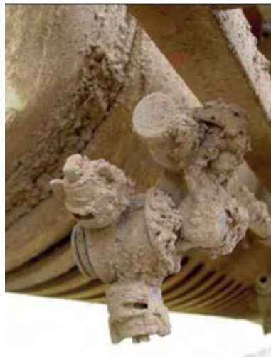
Boquillas obstruidas por suciedad
