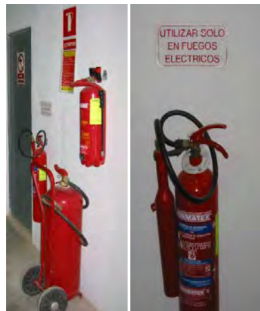
Equipo de extinción de incendios, extintor de CO 2 para fuegos eléctricos
