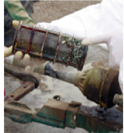
Filtro obstruidas por suciedad
