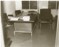
Despacho de Dirección. Estado de las instalaciones tras las inundaciones de octubre de 1973.
