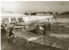
Reparación de las instalaciones una vez días después. Inundaciones de octubre de 1971.
