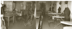
Aulas de Carpintería y de Corte y Confección. Estado de las instalaciones tras las inundaciones de octubre de 1971.
