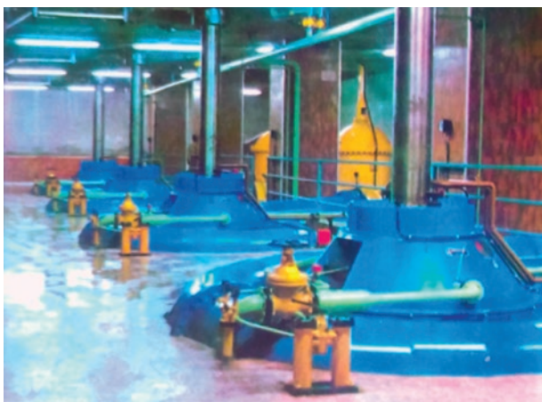
IMPULSIÓN DE OJÓS
