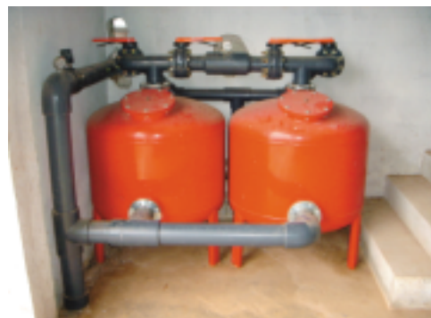
Filtros de arena.
