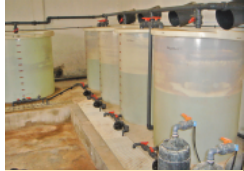
Tanques de fertirrigación.
