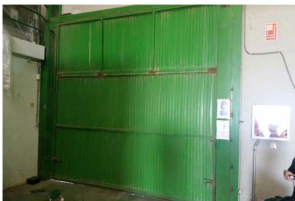
Foto 1. Puerta de apertura manual vertical
