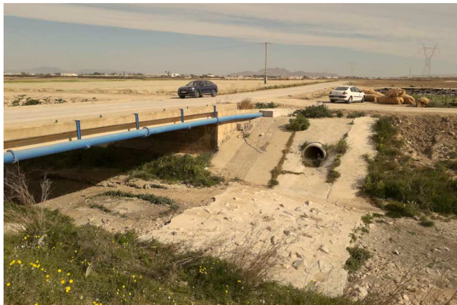
Foto 2. Punto de vertido del aliviadero de la EDAR en la Rambla del Albujión.
