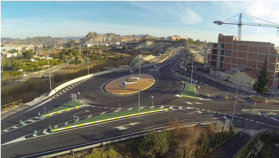
CONSTRUCCIÓN GLORIETA EN INTERSECCIÓN DE LA CARRETERA RM-554 CON EL ACCESO A LA ALGAIDA
