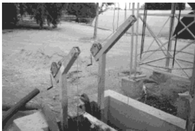
Grúas para elevación de bomba de alimentación y de aireador
