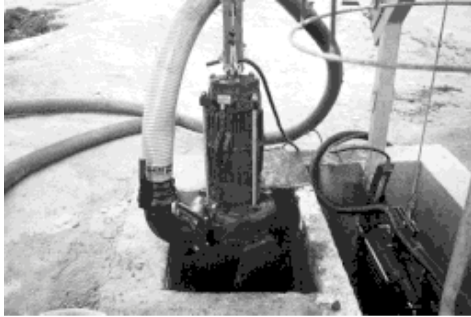
Bomba de alimentación del separador de purines
