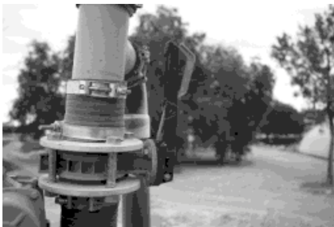
Detalle de la llave de regulación de alimentación del separador
