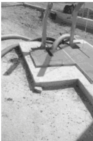
Sistemas de protección en foso subterráneo de recepción de purines
