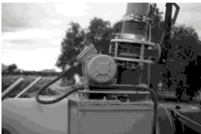
Detalle del vibrador del "compacter"
