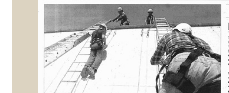
La prevención de riesgos puede ver descuido en la construcción de una obra...
